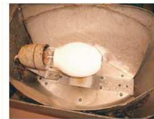
Luminaire sans vasque encrassé (Fu fortement dégradé)
