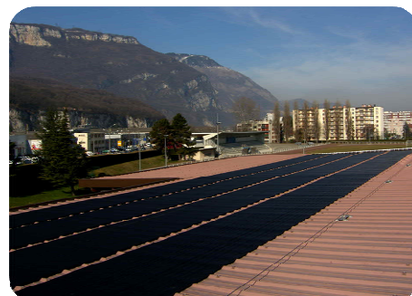
Le capteur solaire est composé de 6 champs de moquette solaire Solerpool®.
