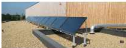
Installations solaires centralisées pour la production d'Eau Chaude Sanitaire en collectif et tertiaire
