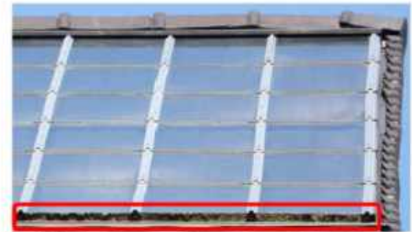
Figure 4 : Champ de capteurs avec écarts d'axe manquant et mauvais alignement des capteurs Capteurs dégradés (Photo extraite du rapport de diagnostic de l'INES)
