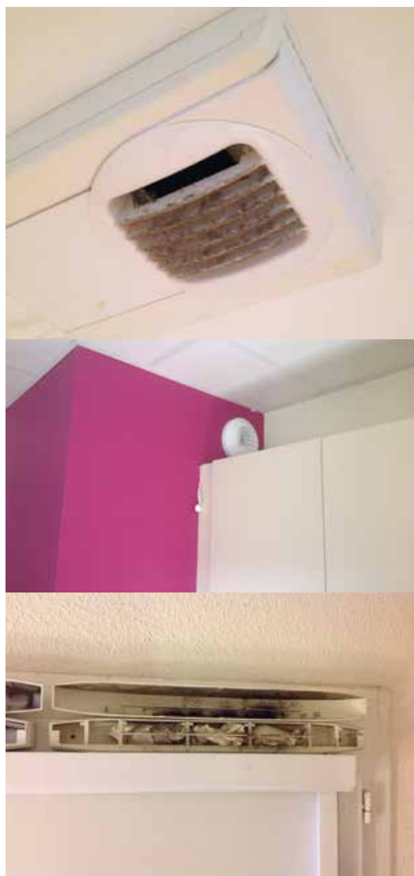
Figure 12 : Exemples de défauts de maintenance ou de conception (source : Agence Qualité Construction)
