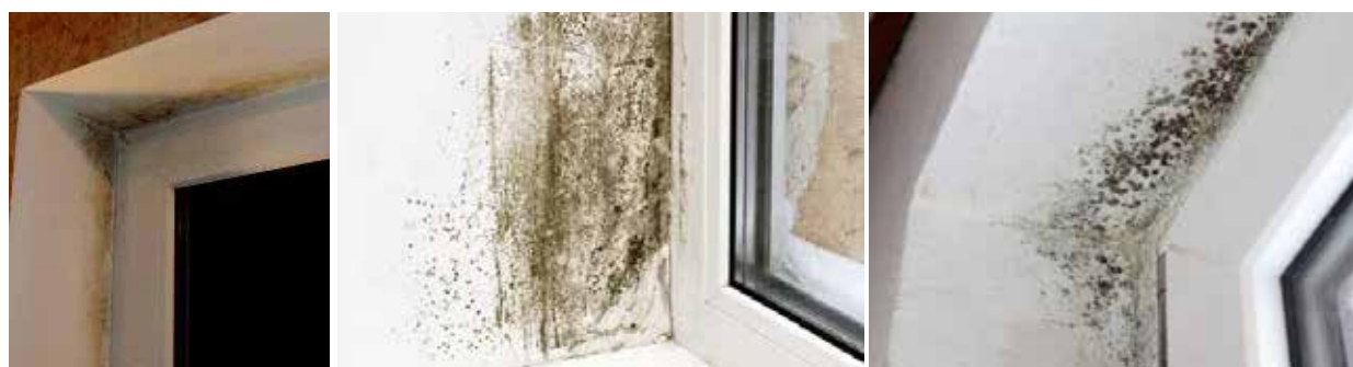
Figure 7 : Images de condensation et moisissure en périphérie de tableau de fenêtre (source : http://www.ponts-thermiques.be/fr/theory/risques )
