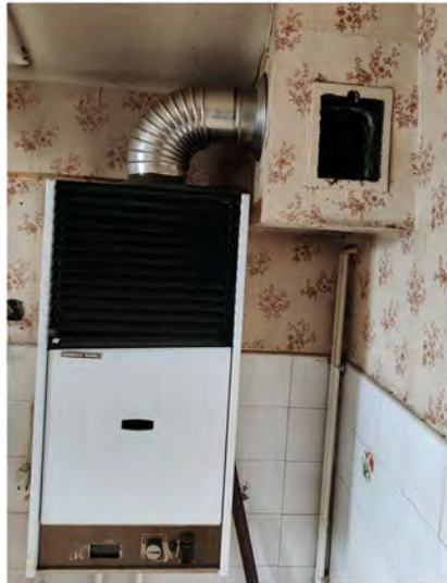
L'une des anciennes chaudières gaz
